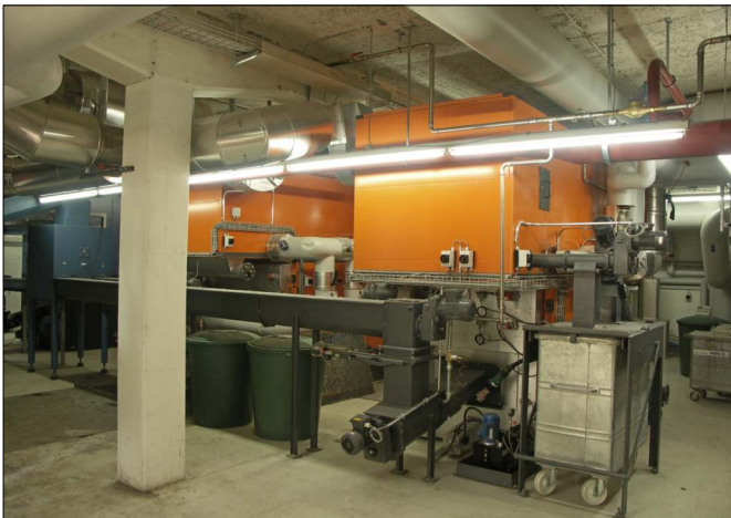
Die Fernheizung im Keller der Schreinerei
